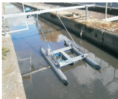
플로팅 센서와 연동 설치된 NivuCompact
