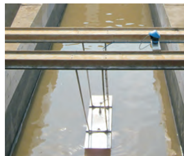
플로팅 센서와 연동 설치된 NivuCompact
