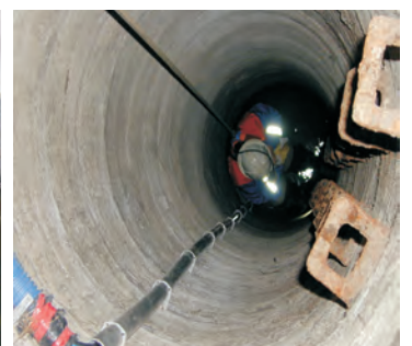
투입 압력식 센서 설치현장
